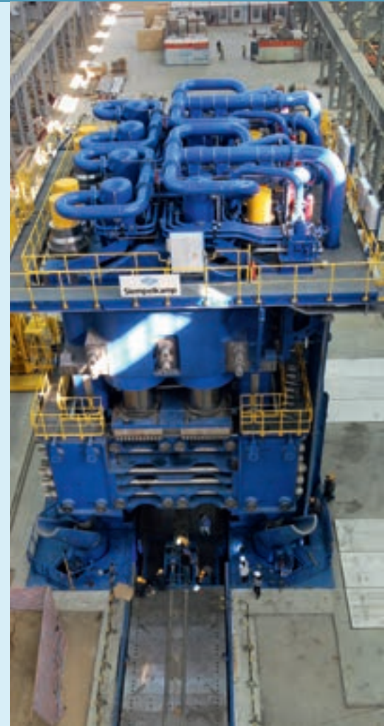
Hydraulik-Verrohrung der acht Presszylinder
