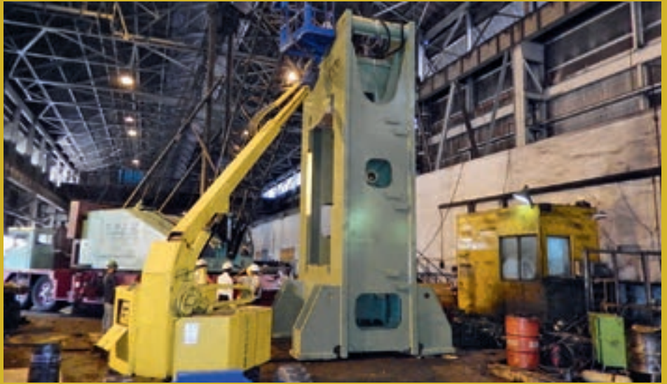
Neuer Pressenrahmen der 20-MN-Pressen
