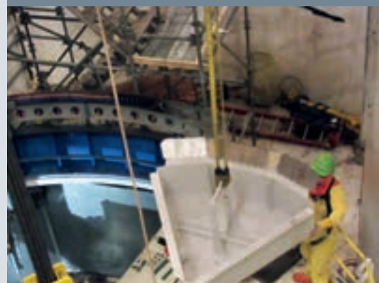
Komplette Installation der Schlackepfannen
