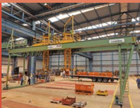
Vollportalkran auf Bodenschienen mit Hublastführungen zum Transport von Blechteilen
