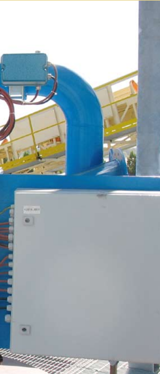
Büttner-Kombibrenner an einem Spänetrockner in der Holzwerkstoffindustrie
