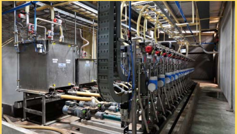
Leimküche mit Dosierung
