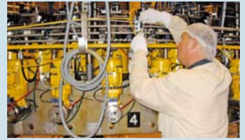
Elektrische Überprüfung der Mutterndrehantriebe
